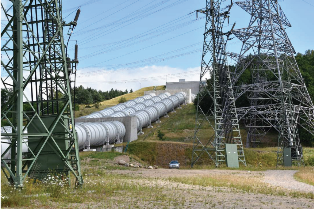
Fot. 2. Trzy rurociągi górnej wody, „sptywające” w dół ku elektrowni.
