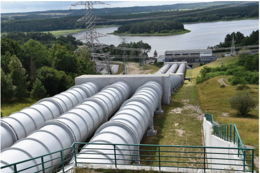
Fot. 3. Rurociągi górnej wody, w oddali wyspa na jeziorze Kwiecko.
