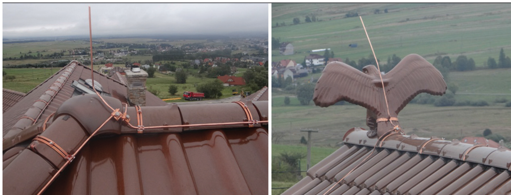
Rys. 4. Urządzenie piorunochronne wykonane z miedzi.
