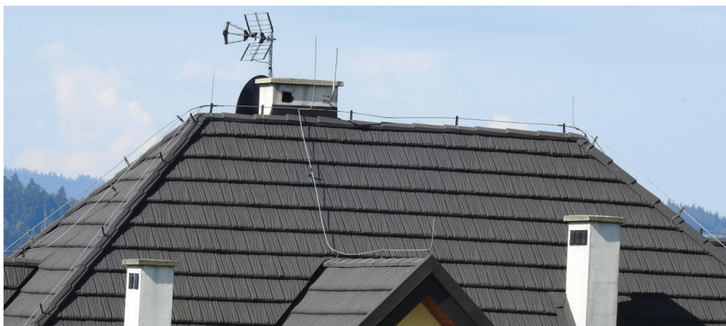
Rys.3. Ochrona odgromowa na dachu z pokryciem bitumicznym.
