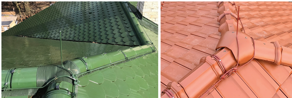
Fot. 5. Przykłady siatki zwodów na dachu budynku dopasowane kolorystycznie do koloru pokrycia dachowego.
