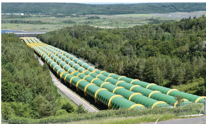
Rurociągi górnej wody pełznące po stoku płaskowyżu w dół ku elektrowni (widok spod zbiornika górnej wody)
